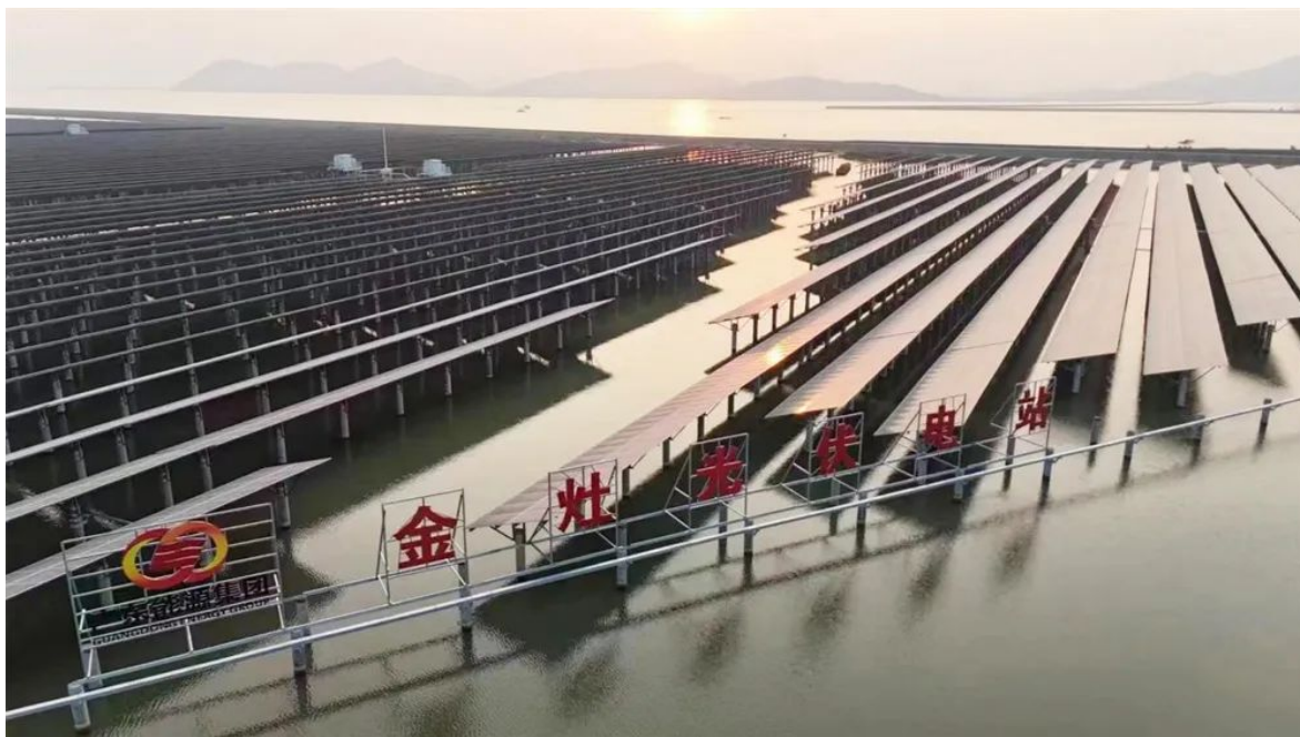
珠海三灶鱼林村光伏复合项目
